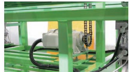
チェーンコンベヤーの駆動部 全てのチェーンコンベヤーを同時に稼働させます。
