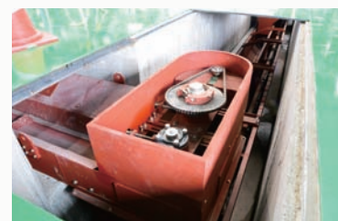
5 支流コンベヤー (3) からメインコンベヤー (2) への乗継部
