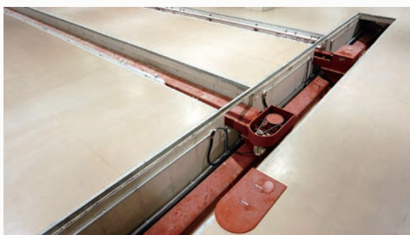
メインコンベヤー（手前）とサブコンベヤー
