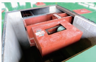
4 メインコンベヤー (1) への最終乗継部 (工場外への搬送)
