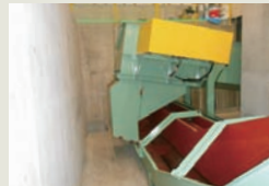
第1コンベヤーからの乗継部 (2ヶ所)
