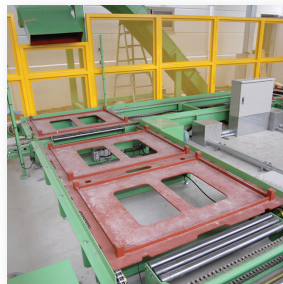
ラウンド式BOX移載装置 (スクラップヤード)
